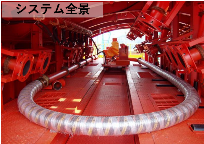
配管挿入状態
