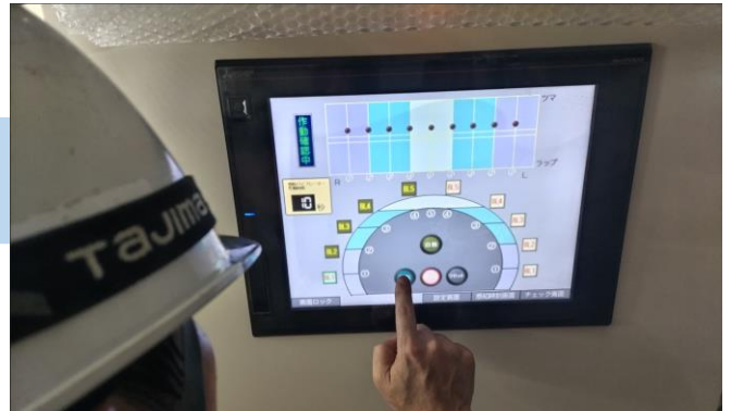
2. 締固めシステム → 型枠バイブレーター集中制御
